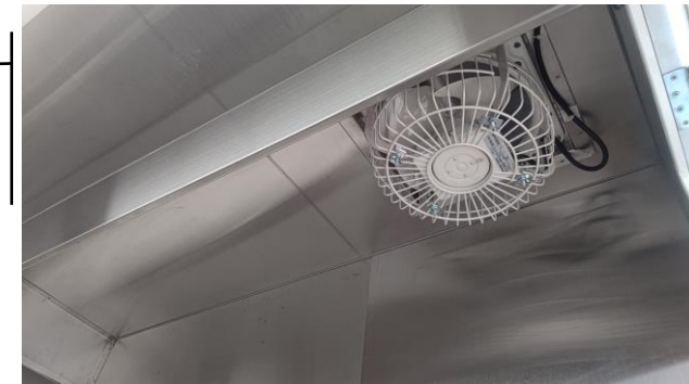
レンジフード付き換気扇
